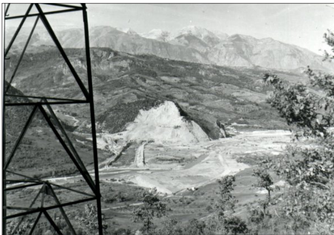
Veduta dalla strada Bomba-Colledimezzo e inquadra il monte Tutoglio, il cantiere diga e si nota la deviazione del fiume, 1957. Foto: N.Berghella.
