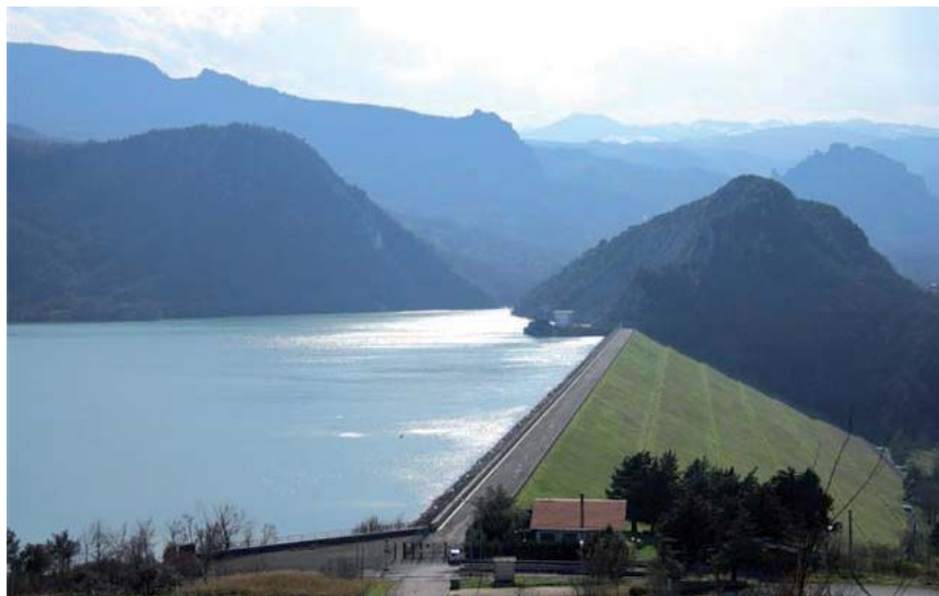
La diga del Lago Sangro: in primo piano la spalla destra della diga che appoggia su una paleofrana mentre la spalla sinistra appoggia su Monte Tutoglio (in secondo piano). La sua struttura in terra battuta potrebbe essere messa a rischio da fenomeni di subsidenza che ne comprometterebbero la stabilità con gravissimi rischi per le popolazioni della valle del Sangro"
